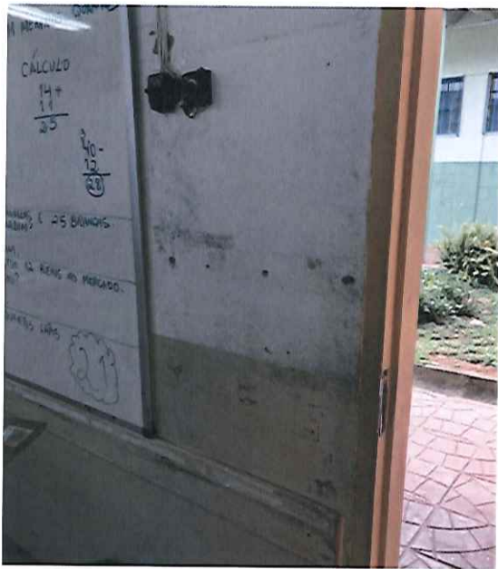
PINTURA ANTES DA MANUTENÇÃO (15/10/2019 - 14:57)
