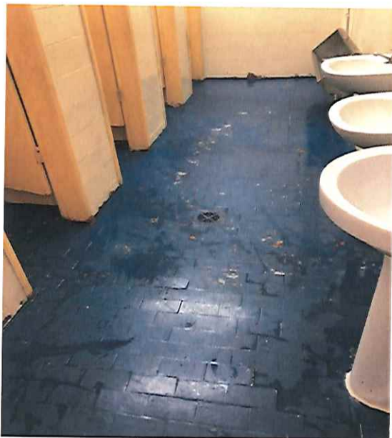
PISO CERÂMICO ANTES DA MANUTENÇÃO 15/10/2019 - 15:15
