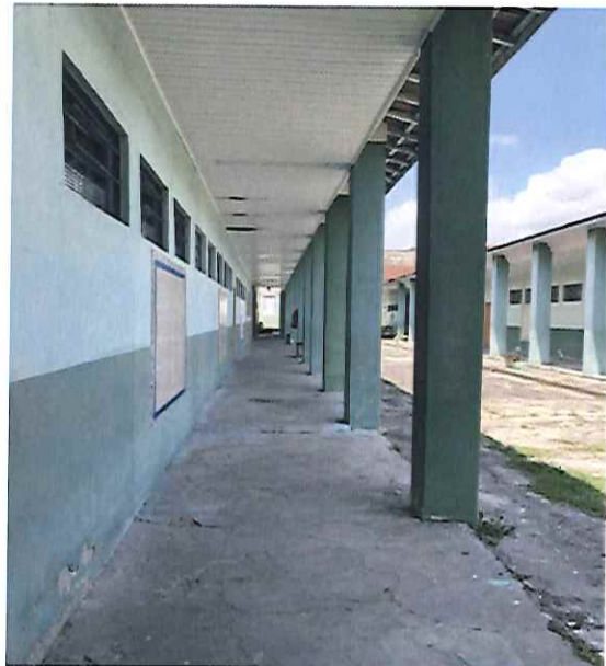
PISO DE CONCRETO ANTES DA MANUTENÇÃO (15/10/2019 - 16:40)
