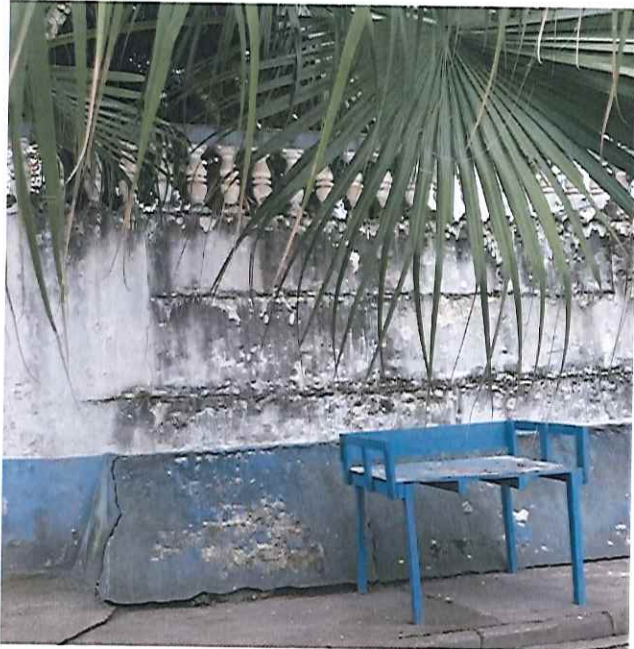
PINTURA ANTES DA MANUTENÇÃO (04/09/2019 - 10:19)
